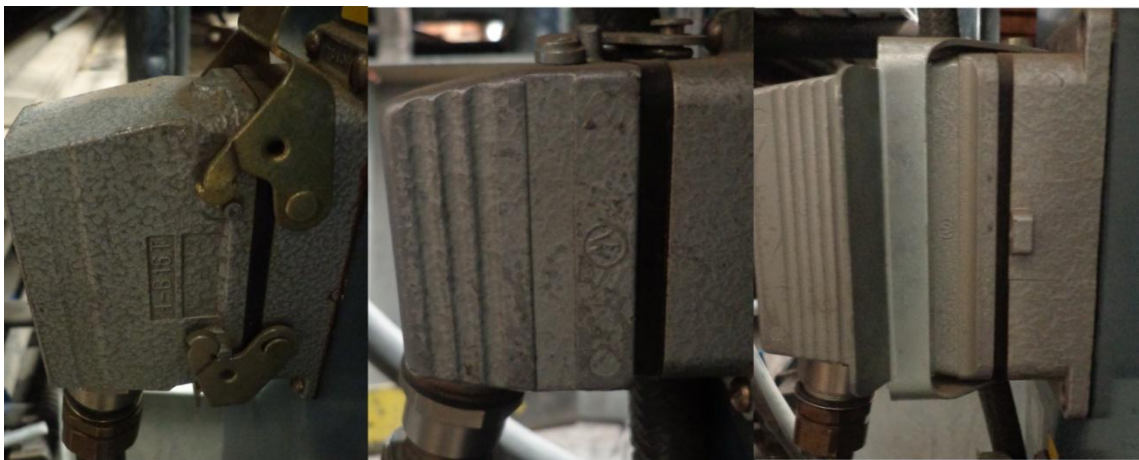
Figura III.57. Borneras de distribución de cables
