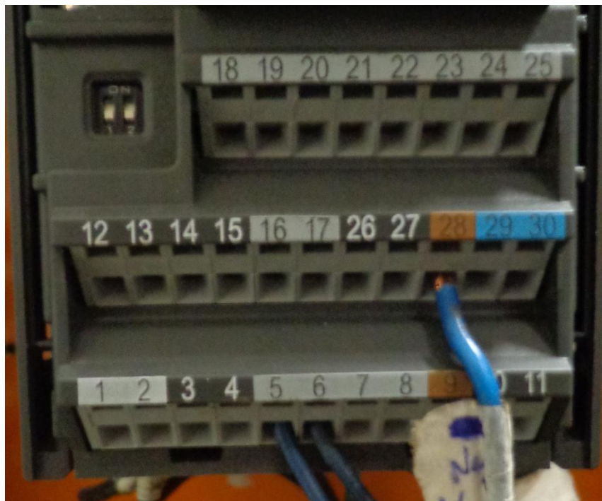
Figura III.70. Borneras del variador para modo remoto
