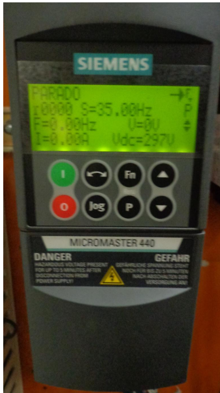
Figura II.9. Variador empleado en el proyecto
