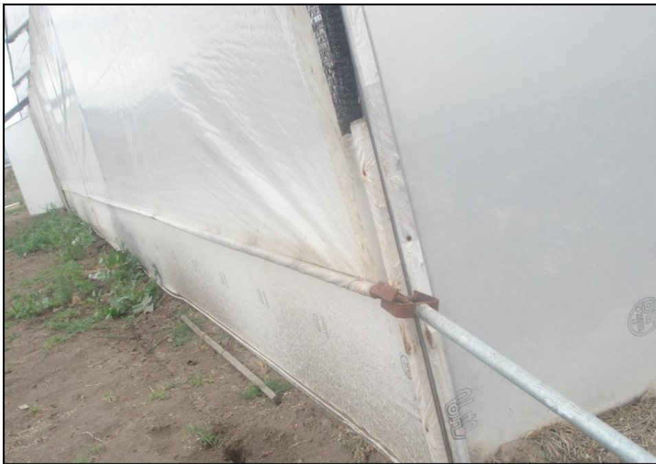
Figura 21 Sistema mecánico de cortinas del invernadero
