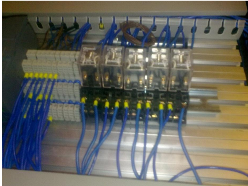
Figura IV-16 Modulo de control eléctrico
