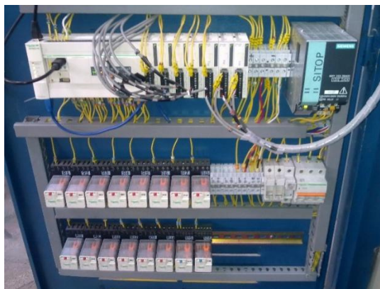
Figurall-53. Tablero eléctrico de control máquina 1. Fuente: Los autores
