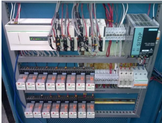
Figurall-54. Tablero eléctrico de control máquina 2 Fuente: Los autores
