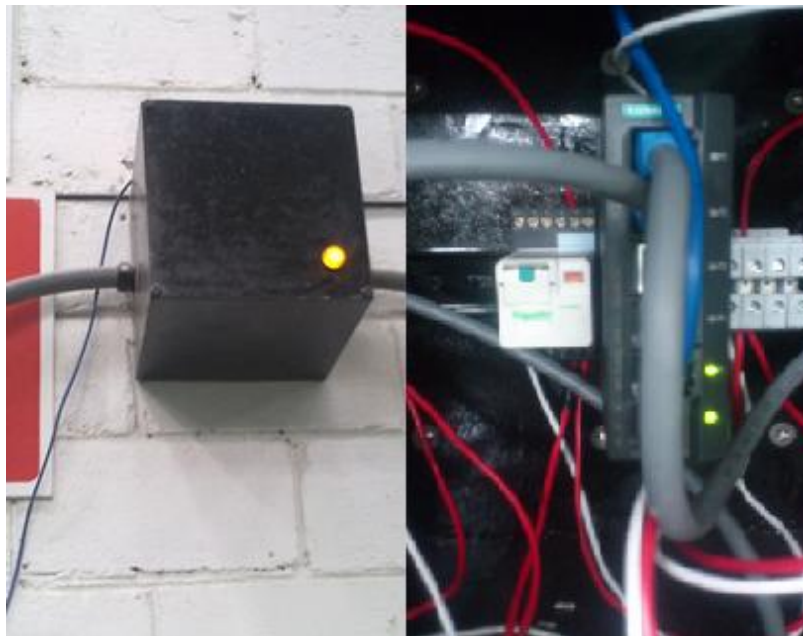
Figurall-55. Caja de protección del switch industrial Fuente: Los autores
