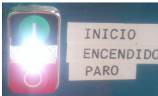
Fig. 11. Botonera de encendido del PLC
