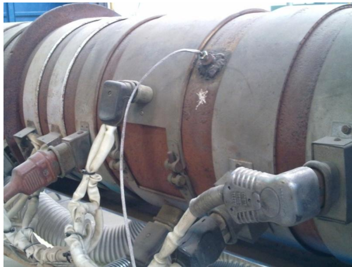
Figura III-46. Termocupla ubicada en el cañón Fuente: Los autores
