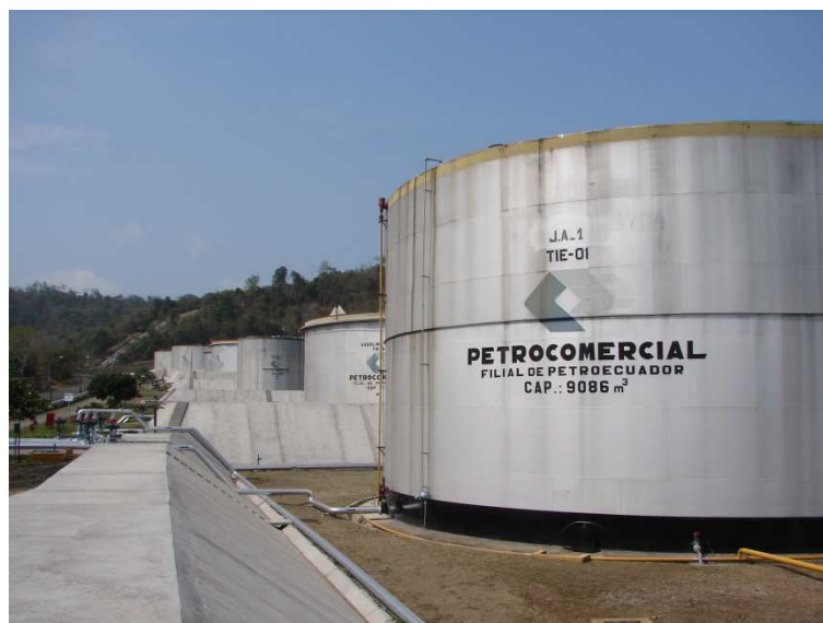
Figura 3.1: Fotografía de los Tanques de Almacenamiento
