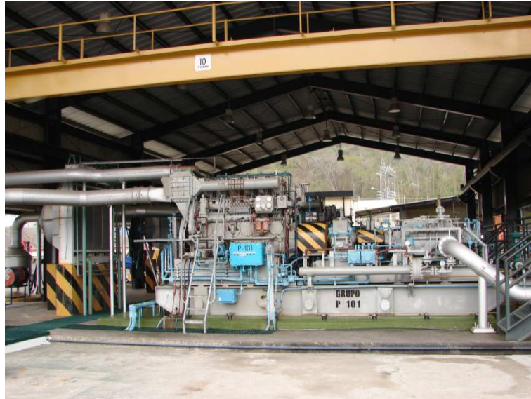
Figura 3.7: Grupo Motobomba a Diesel
