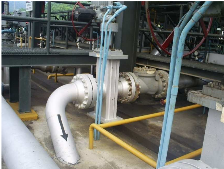
Figura 3.16: Tubería de Descarga de la P 104
