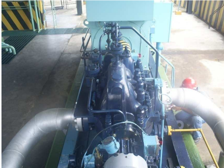
Figura 3.15: Bomba P 104 con Tuberías de Succión y Descarga
