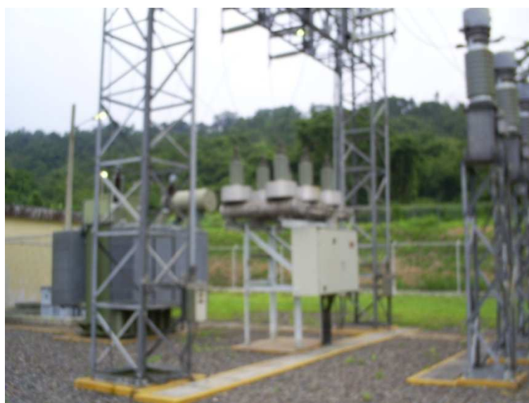
Figura 3: Subestación Eléctrica. Este es el lugar de recepción de la Energía Eléctrica entregada por el Sistema Nacional Interconectado (SNI)
