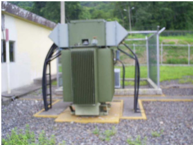
Figura 3.20: Transformador del Variador, 13800/2800 V.
