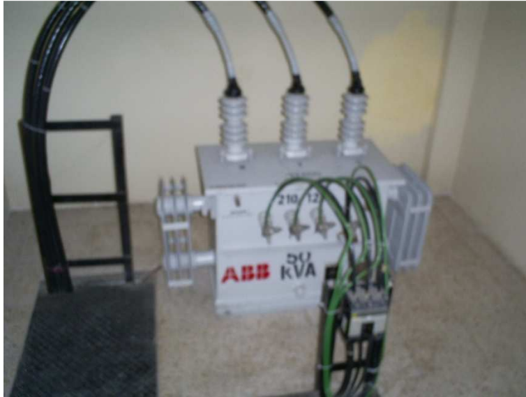
Figura 3.21: Transformador de baja, 13800/ 210 y 120 voltios.
