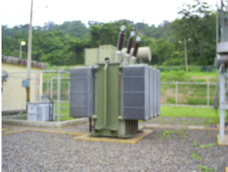
Figura 3.19: Transformador Principal, 69000 /13800 V
