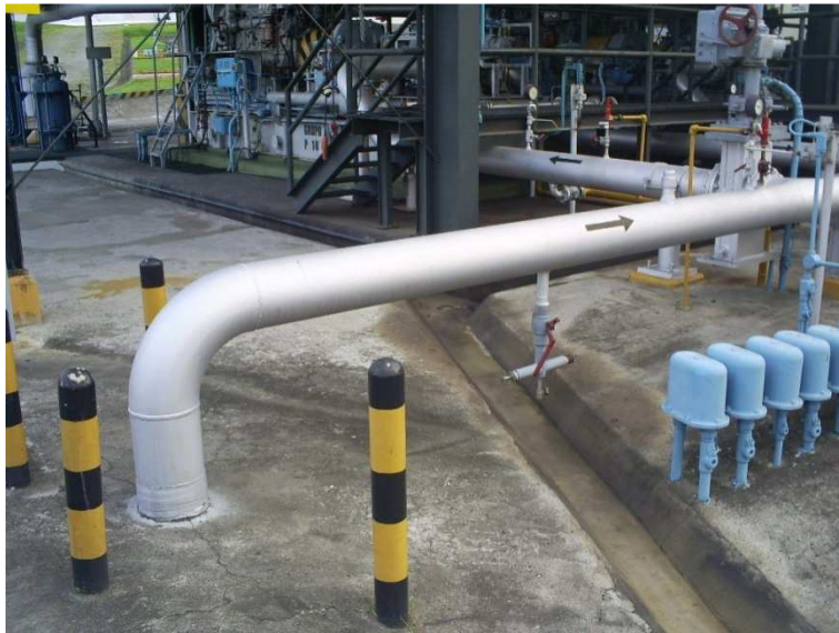
Figura 3.14: Tubería de Descarga de las Bombas Booster
