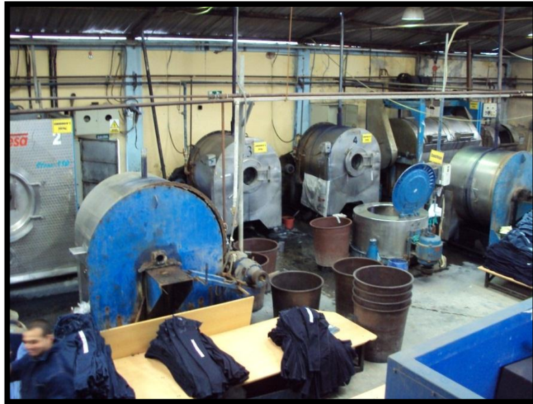
Foto 4. Sala de Máquinas
