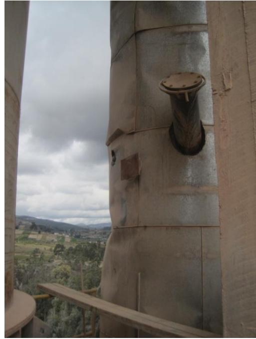
Foto N°6 Etapa 1-Ducto de succión
