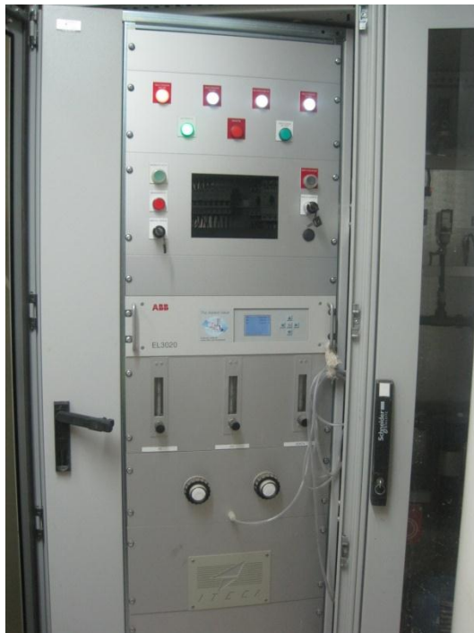
Foto N°15 Cabina ITECA SOCADEI
