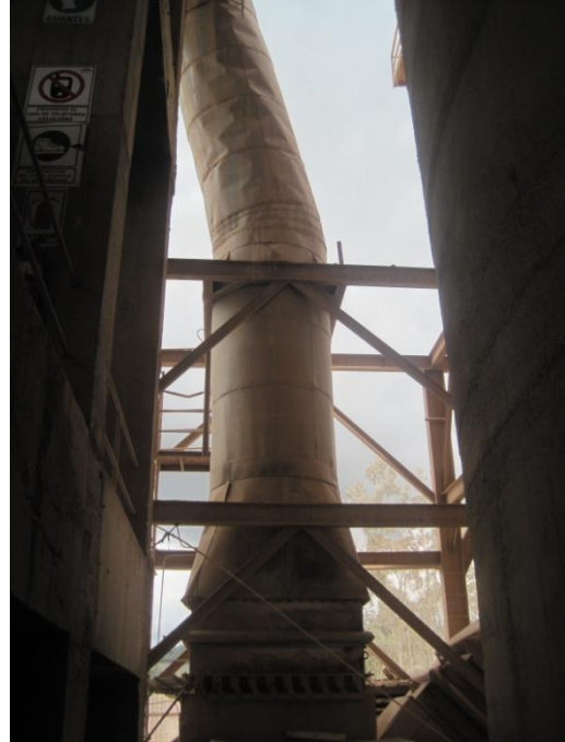
Foto N°2 Ducto de succión de gases del horno
