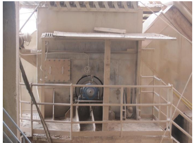
Foto N°4 Ventilador 1 o de tiro
