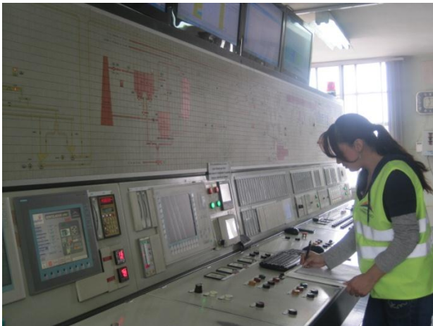
Foto N°3 Toma de datos-cuarto de control
