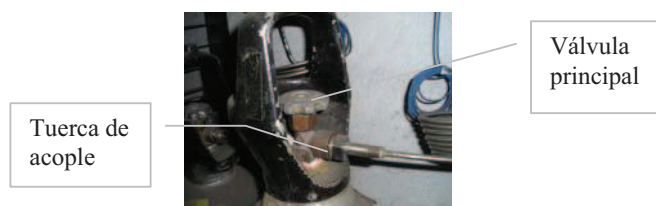
Figura 3.55 Válvula principal del cilindro de argón.
