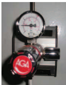
Figura 3.35 Manómetro de ingreso de gas argón al espectrómetro.
