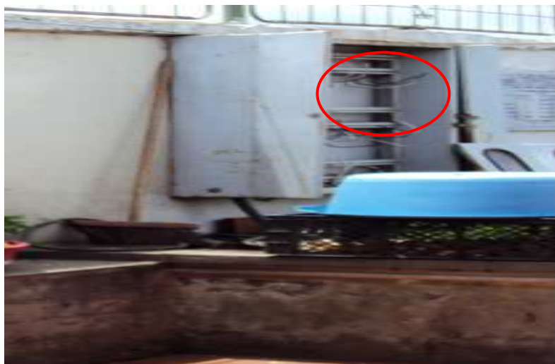
Fotografía 12. Falta mantenimiento Instalaciones eléctricas.
