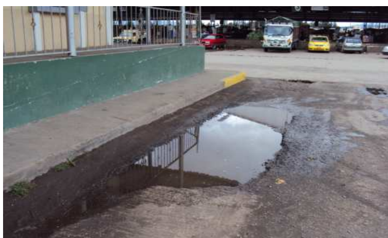
Fotografía 11. Falta de canalización fuera del centro comercial.
