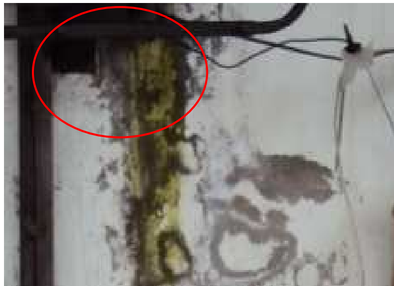
Fotografía 14. Filtración de agua en las paredes.
