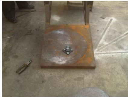
Figura 93. Planchas metálicas soldadas en la parte inferior de la estructura
