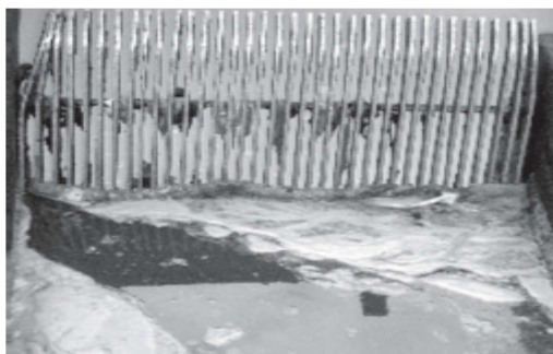
Fig. 2. Rejilla de retención de sólidos gruesos
