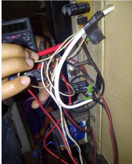
Figura 125. Comprobación de voltaje de ICM
