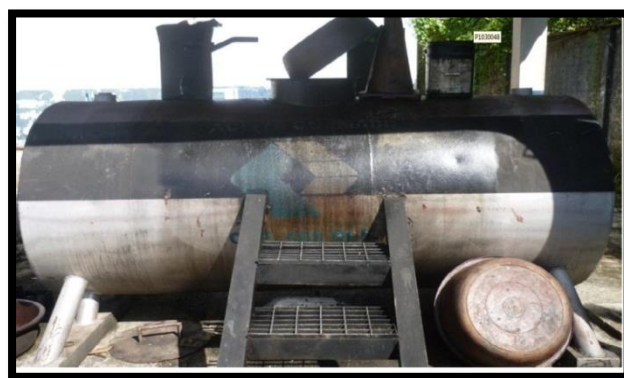
Figura 24. Depósito de aceites usados.
