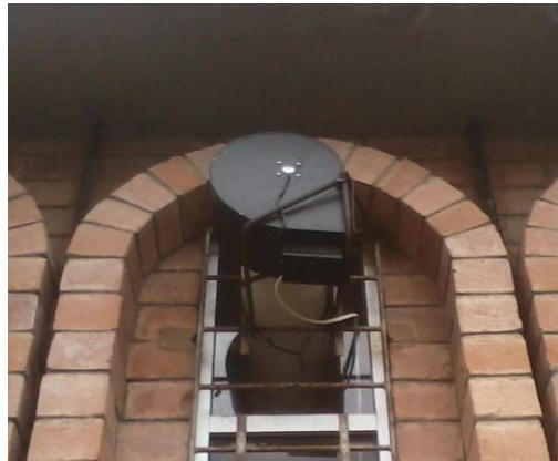
Foto 7 Ventilador utilizado para la extracción de gases de la planta piloto
