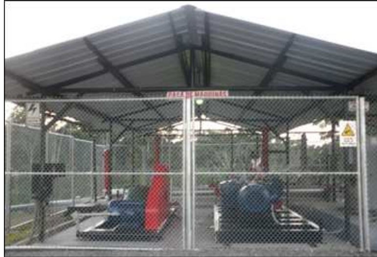
Figura 12. Bombas de transferencia
