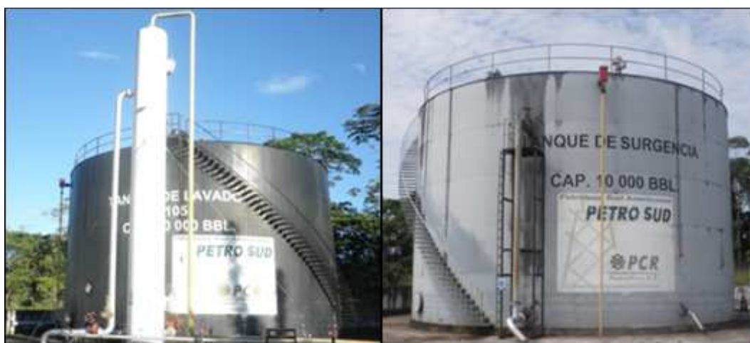
Figura 11. Tanque de lavado (washtank T-105) y tanque de surgencia (surge tank)
