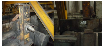
Figura 36. Pirómetro AST 450 instalado a la Salida del Horno
