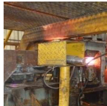
Figura 37. Pirómetro instalado a la entrada del tren Continuo
