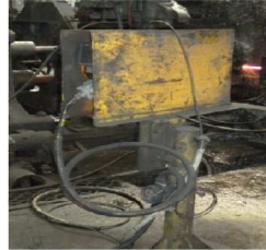
Figura 38. Pirómetro instalado en la caseta 20 tren acabador
