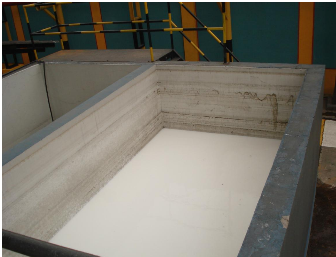
FOTO 2-2. TANQUE DE ALMACENAMIENTO DEL AGUA DE LAVADO DEL REACTOR MQ5
