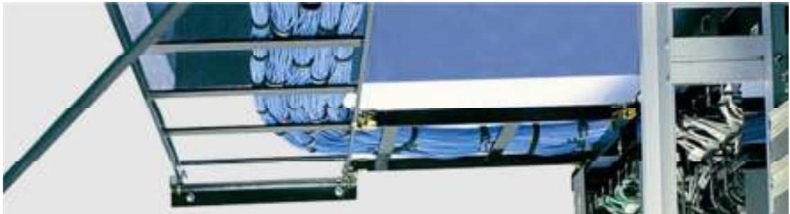
Figura II. 33Bandejas y Escalerillas
