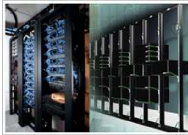
Figura II. 6 Sala de Telecomunicaciones
