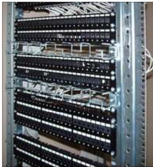
Figura II. 21 Paneles de parcheo montados en bastidor
