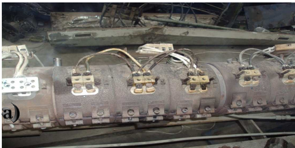
Figura 48. Estado de algunos elementos defectuosos de la máquina.
