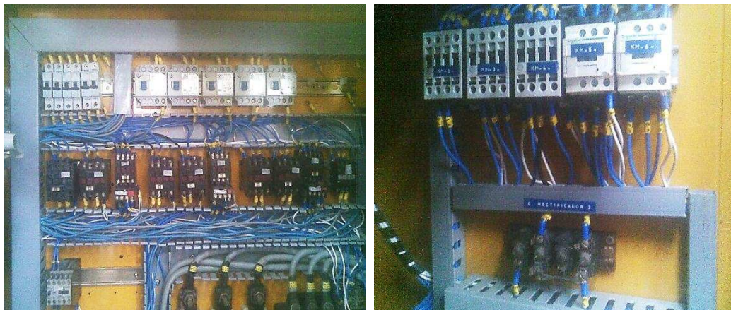
Figura 57. Cableado del tablero de control
