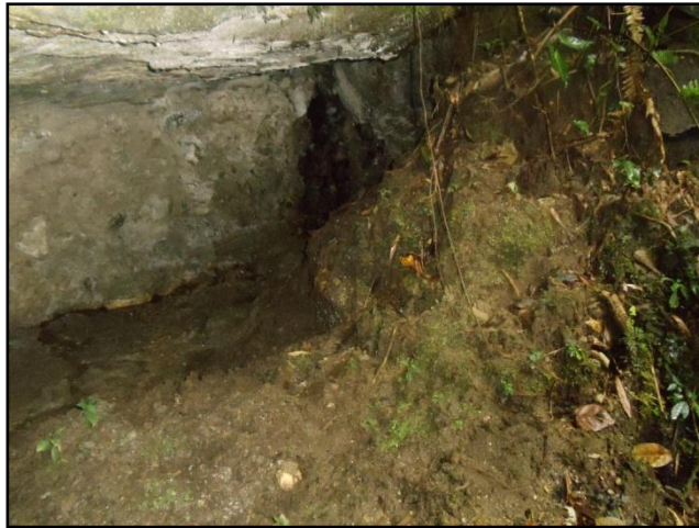
Imagen 7. Erosión del suelo
