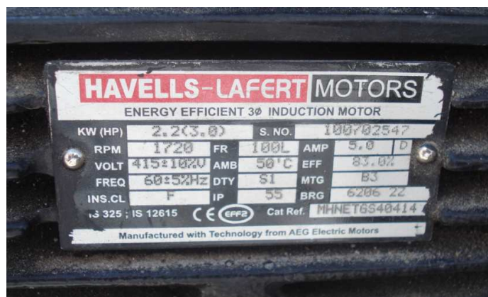
Figura 52. Datos placa motor bomba 3-2
