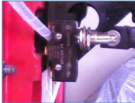
Figura 55. Interruptor de luces de freno instalado.
