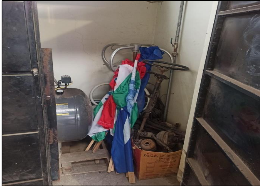
Ilustración 3-6: Estado actual del Área de Aire Comprimido del Taller Institucional Automotriz.
