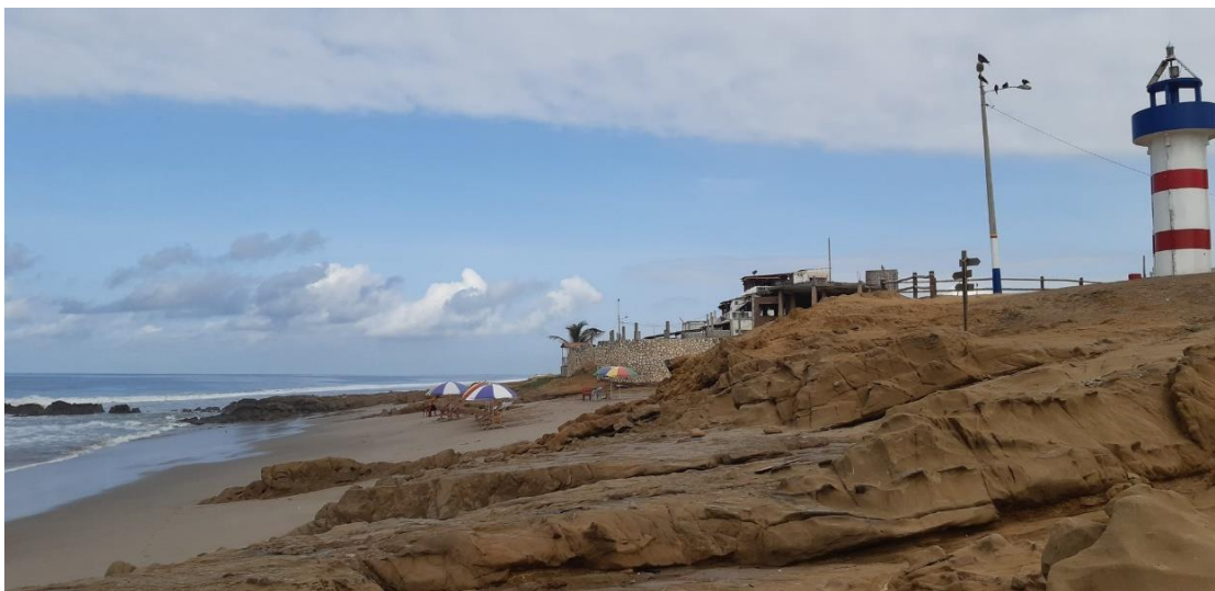
Ilustración 4-8: Factores erosivos, precipitaciones y corrientes de agua, se evidencia cárcavas producto de corrientes de agua en el lugar.
