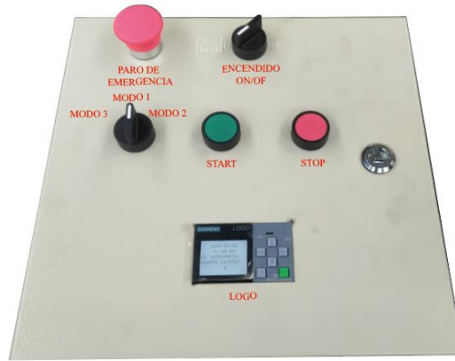
Ilustración 3-106: Tablero del Sistema de control automático. Realizado por: Rivera Bryan; Uzhca, José, 2024
