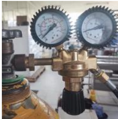
Fotografía 5 Manómetros del tanque nitrógeno.
