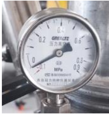
Fotografía 8 Manómetro del reactor con presión baja.
