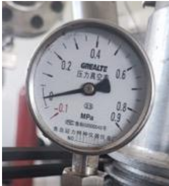
Fotografía 7 Manómetro del reactor con presión alta.
