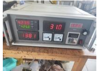
Fotografía 9 Panel de control.
