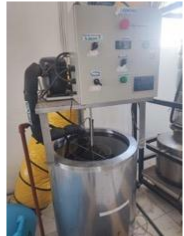
Fotografía 3 Sistema de enfriamiento.
