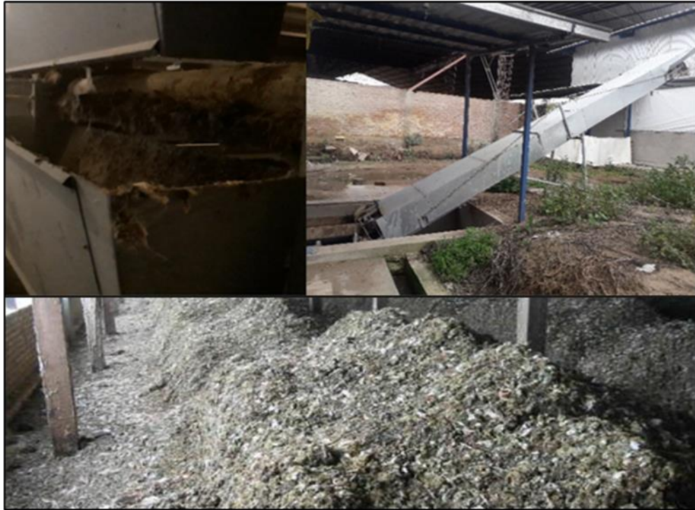
Figura 9-2: Transportador interno y externo de gallinaza o abono.
