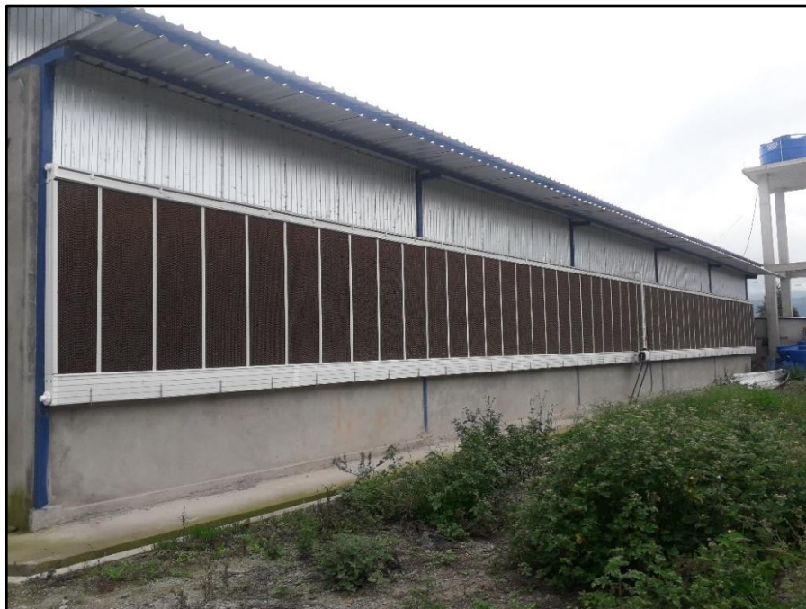
Paneles húmedos laterales de los galpones.
