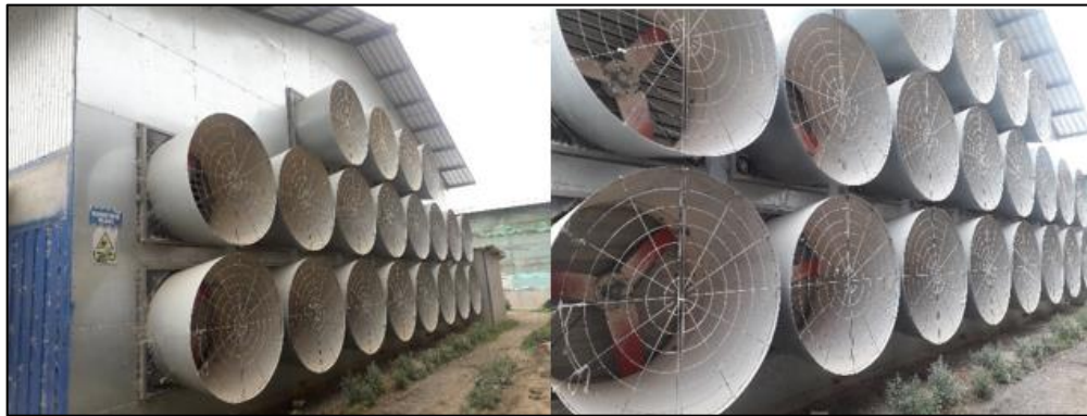
Figura 8-2: Extractores exteriores de aire.
