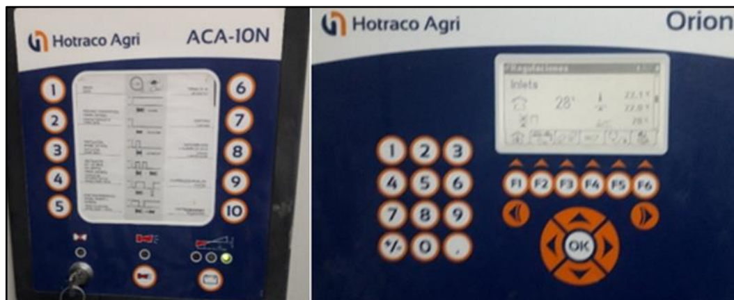
Figura 6-2: Paneles de control y alarmas internas del galpón.
