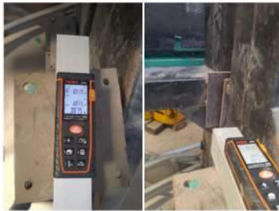
Figura 60-3. Calibración de sistema de medición laser
