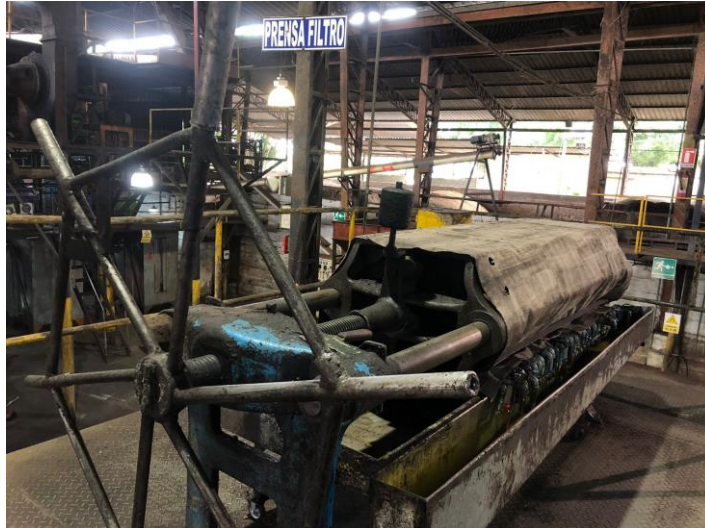
Figura 7-4: Área de proceso de filtrado de aceite
