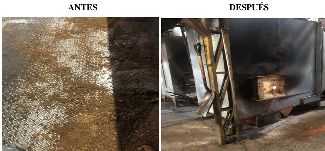
Figura 10-5: Habilitación de la secadora y estandarización de procesos
