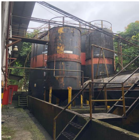
Figura 8-4: Área de proceso de almacenamiento de aceites
