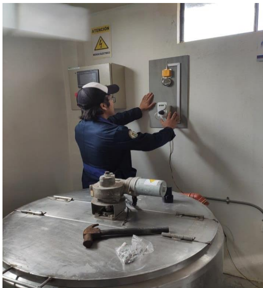
Ilustración 4-8: Instalación de alarma sonora con temporizador programable
