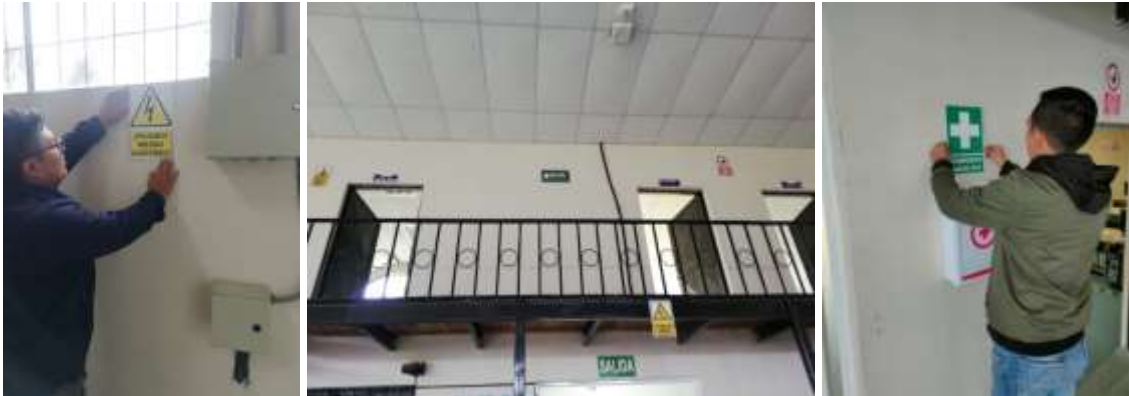
Ilustración 4-19: Implementación de señalética adicional
