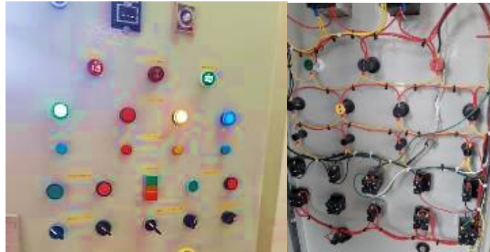
Ilustración 2-2: Tablero de control de automático
