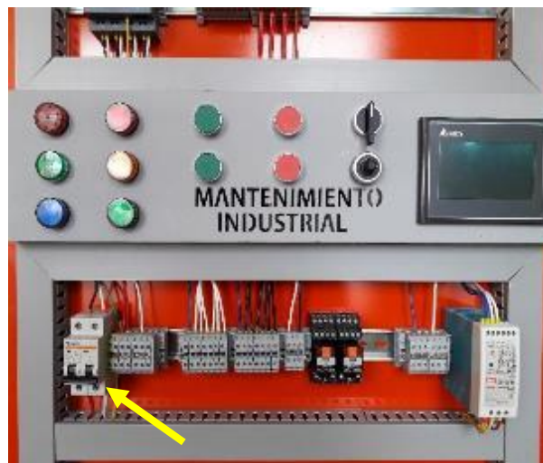
Ilustración 11: Desconexión de los cables y apagado del módulo
