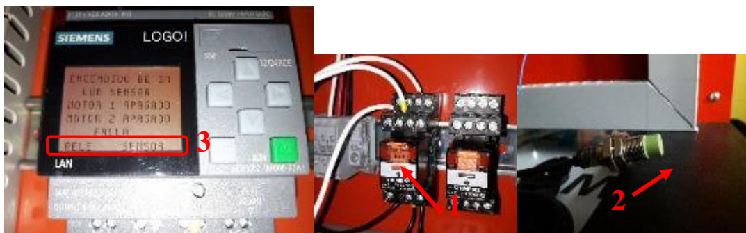
Ilustración 36: Simulación de la falla en el módulo.
