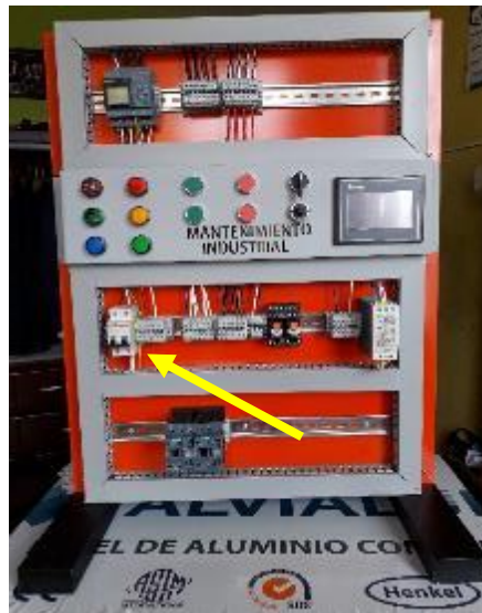
Ilustración 1: Encendido del módulo.
