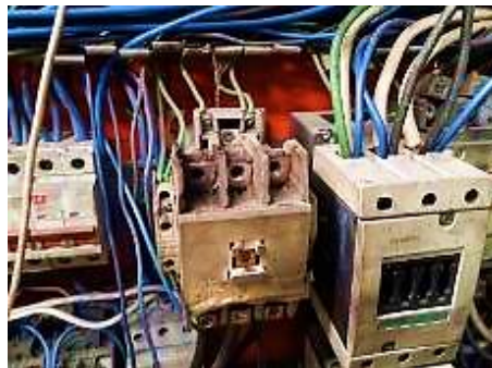
Ilustración 22: Falla eléctrica en un contactor.
