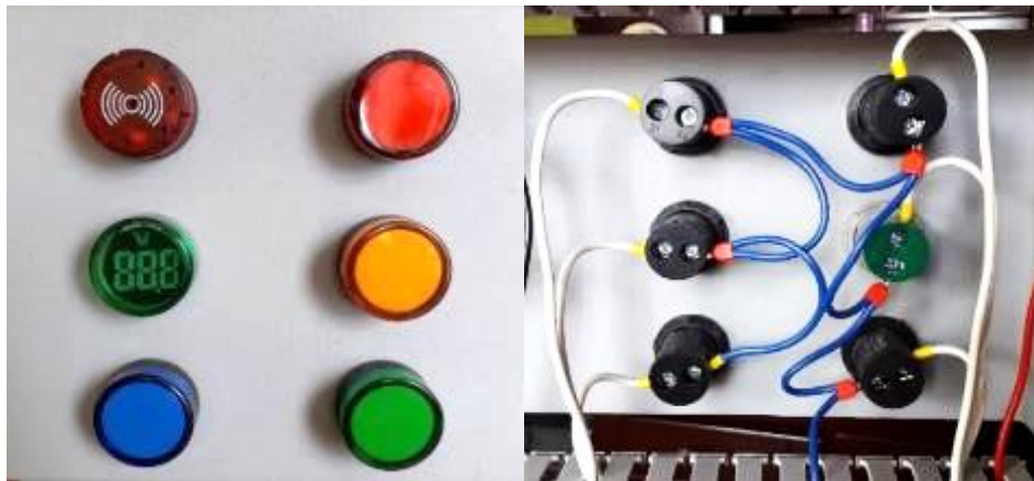
Ilustración 3-28: Luces piloto de colores, voltímetro y luz de alarma
