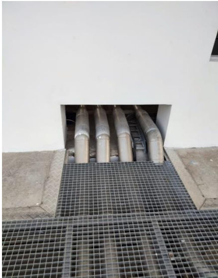
Tubos de Aireación
