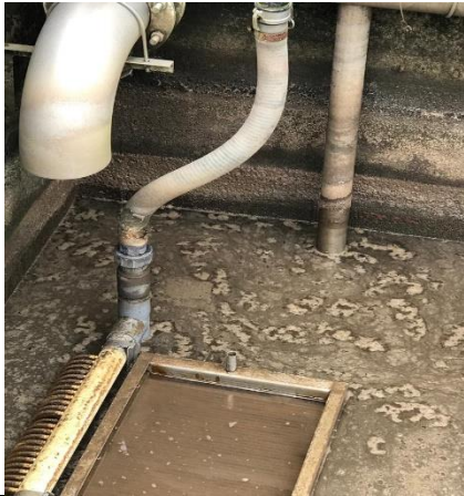
Membranas con daño en la manguera de succión
