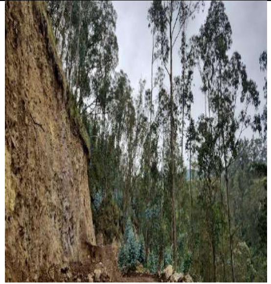
Deslizamiento de tierra
