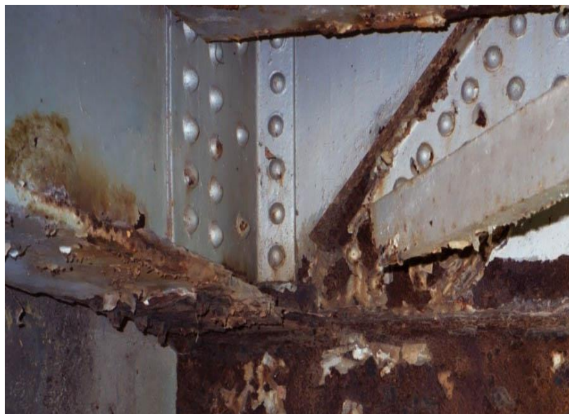
Ilustración 2-3: Acero estructural Corroído
