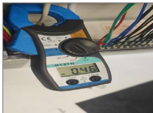
Ilustración 4-9: Evidencia de la medición de corriente total
