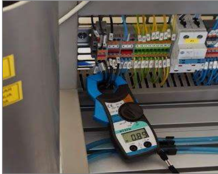
Ilustración 4-10: Medición de corriente AC del módulo IPC 201
