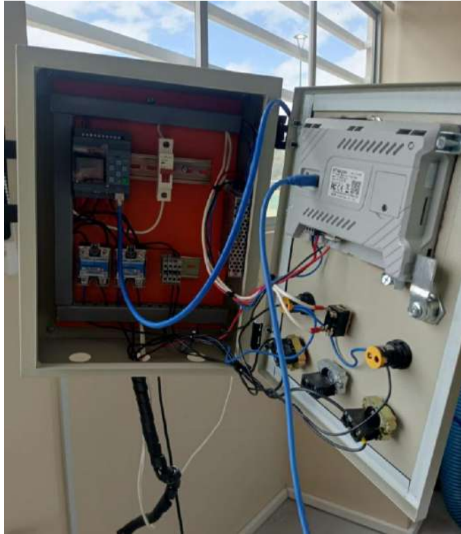
Ilustración 3-31: Implementación de módulo PLC y HMI en el tablero de control general
