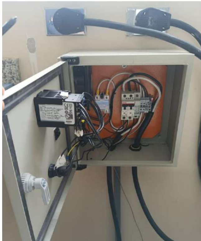
Ilustración 3-32: Implementación del tablero del horno A
