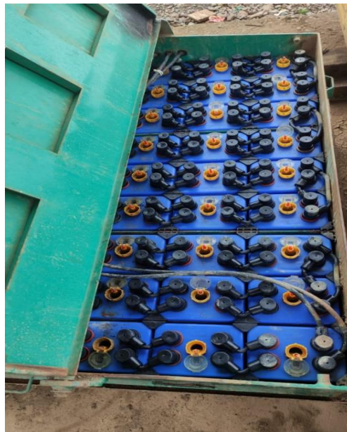
Ilustración 3-6: Batería de locomotora
