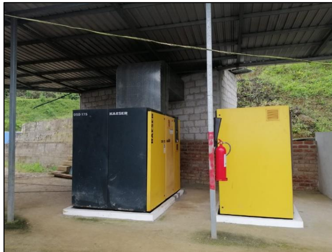
Ilustración 3-1: Generadores de energía eléctrica
