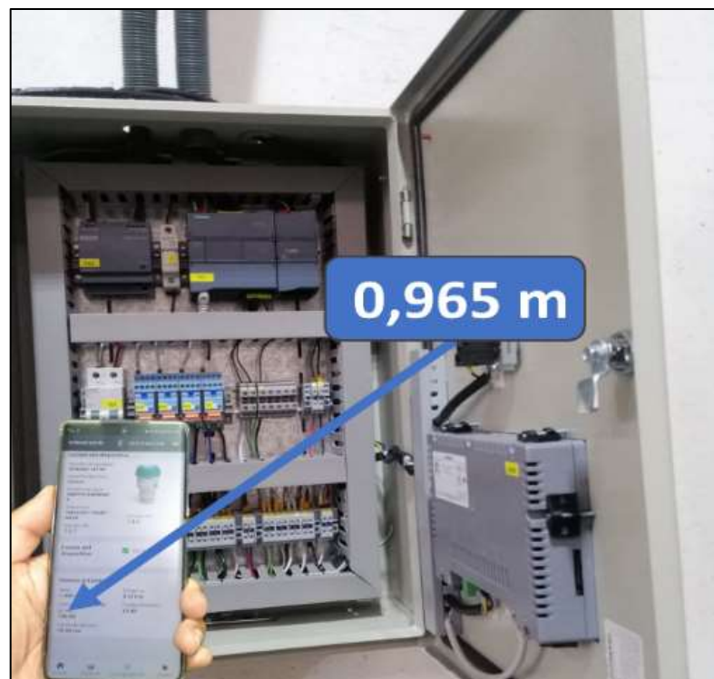
Ilustración 4-4: Prueba estabilidad sensor SITRANS LR140
