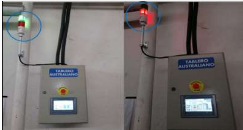
Ilustración 4-8: Prueba de funcionamiento de alerta de seguridad
