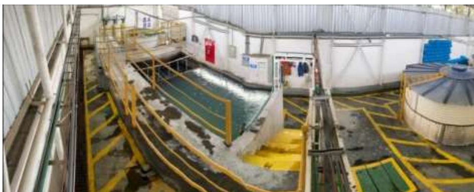
Ilustración 2-1: Planta de tratamiento de agua Novacero
