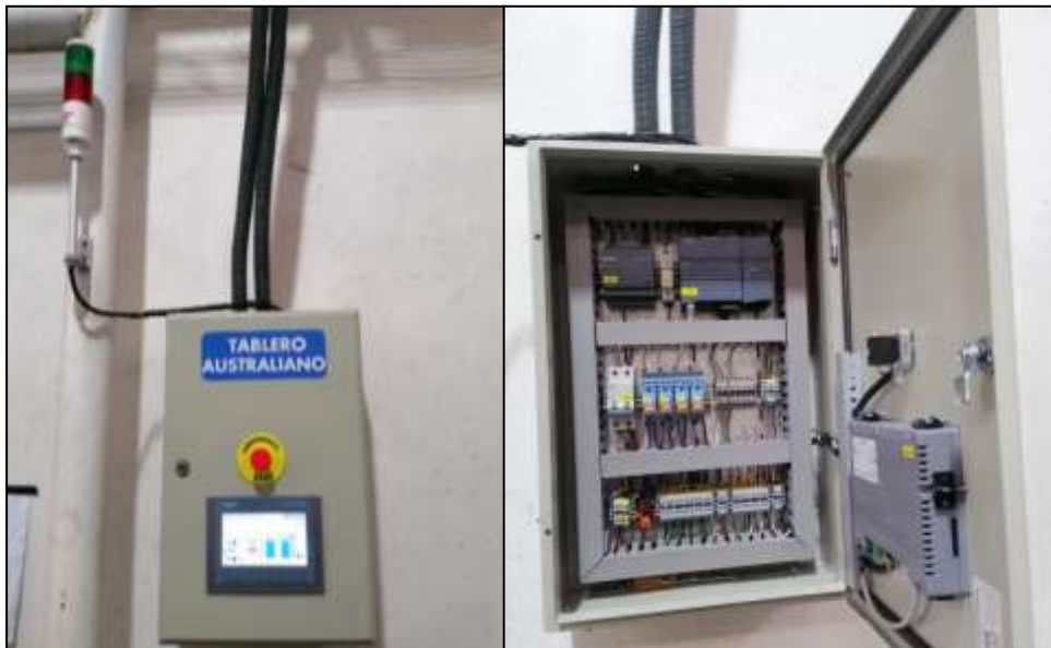
Ilustración 4-1: Tablero del sistema automatizado
