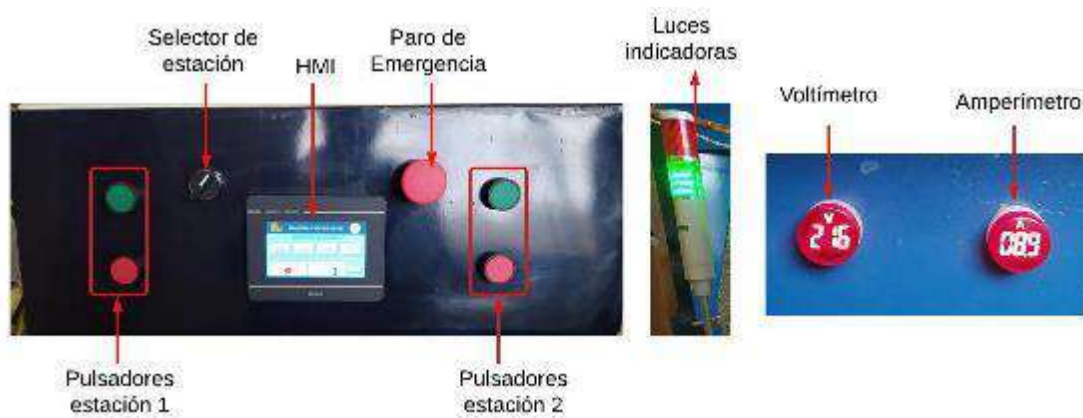
Imagen 3. Vista general del tablero de control, sistema neumático e hidráulico
