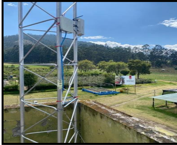
Ilustración 40-3: Antena emisora Mikrotik, edificio central
