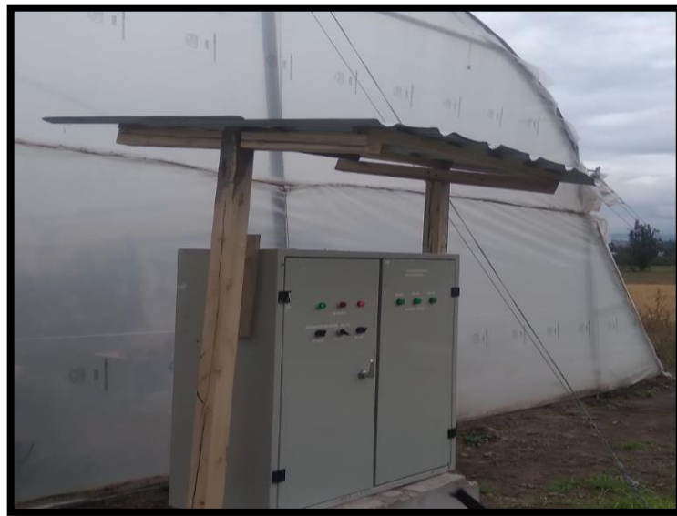
Ilustración 37-3: Caja térmica principal del invernadero.
