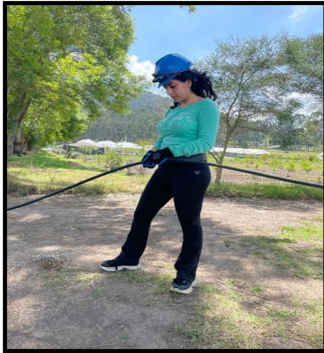
Ilustración 18-3: Cableado de instalaciones eléctricas al invernadero de tomate.
