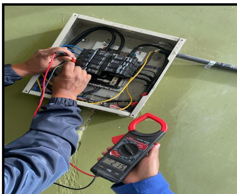
Ilustración 17-3: Caja electrica del efificio principiapl de Tunshi
