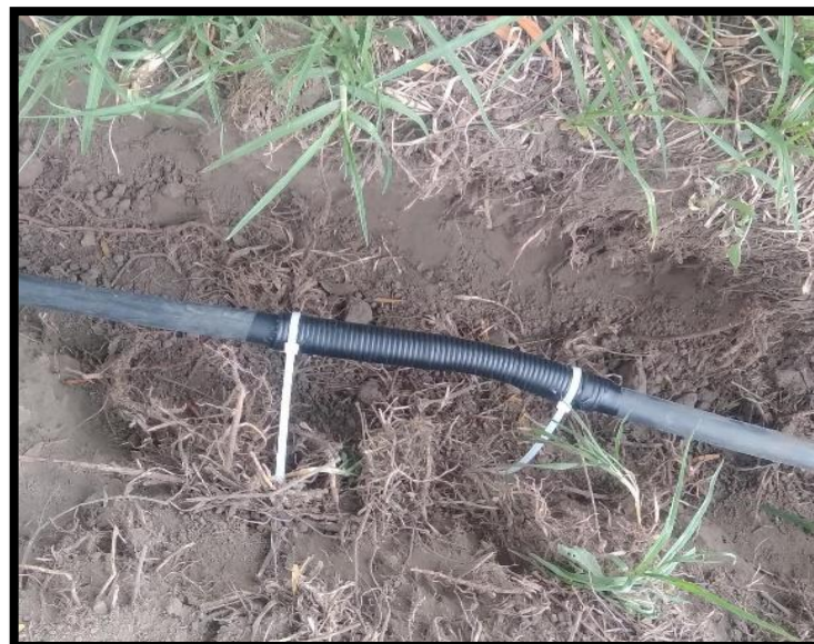
Ilustración 36-3: Tubería con el cableado eléctrico
