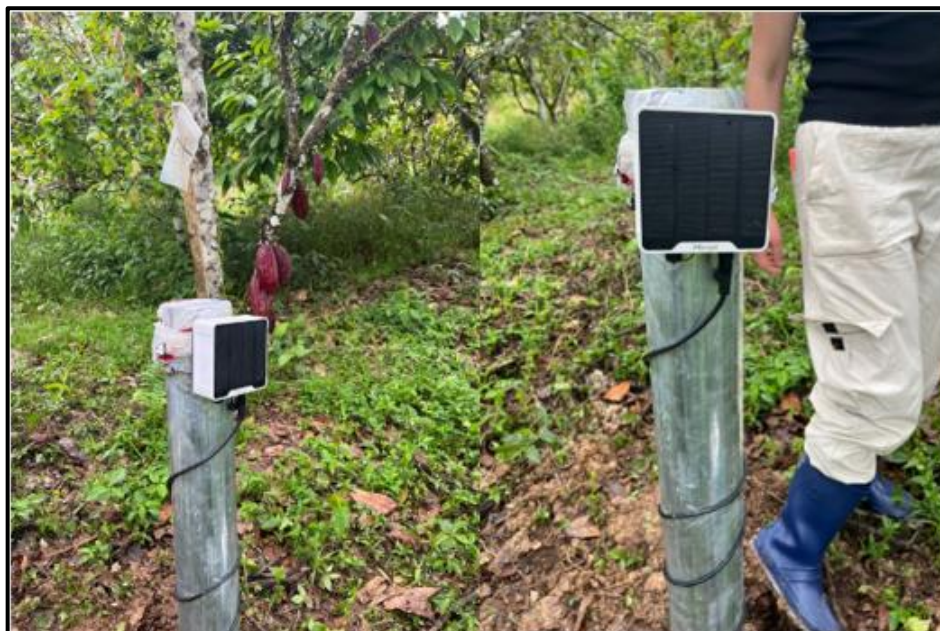
Ilustración 11-3: Montaje en poste del segundo nodo Lora con el controlador.
