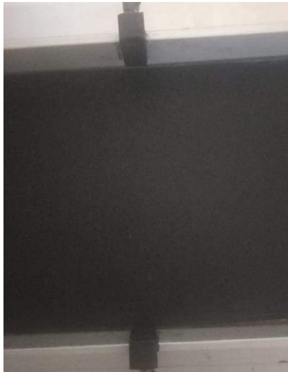
Figura 8-2. Sensor de presencia en la banda trasportadora.
