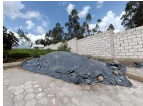
Ilustración 4-9: Abandono de material constructivo
