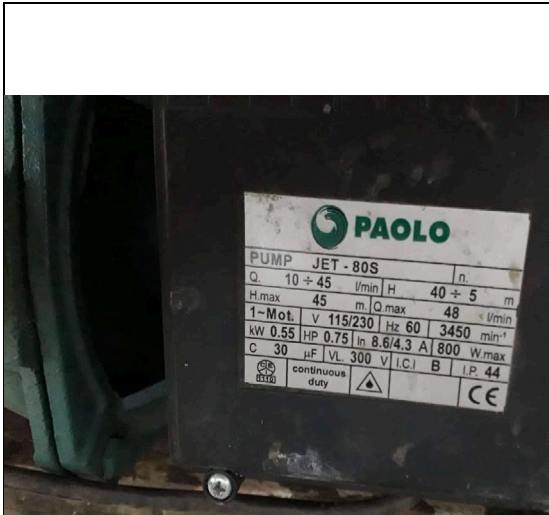
Fig.1. Bomba de agua
