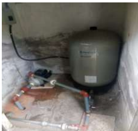
Cuarto de maquinas y tuberias de agua
