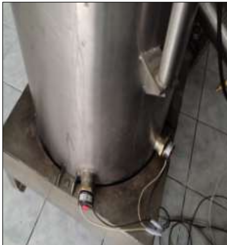
Figura 17-3: Prueba de encendido de la resistencia tubular
