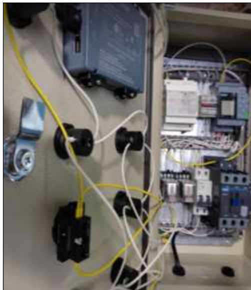
Figura 23-3: Cableado del tablero y sus componentes
