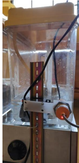
Figura 3-3: Presencia de líquido en zona de censado
