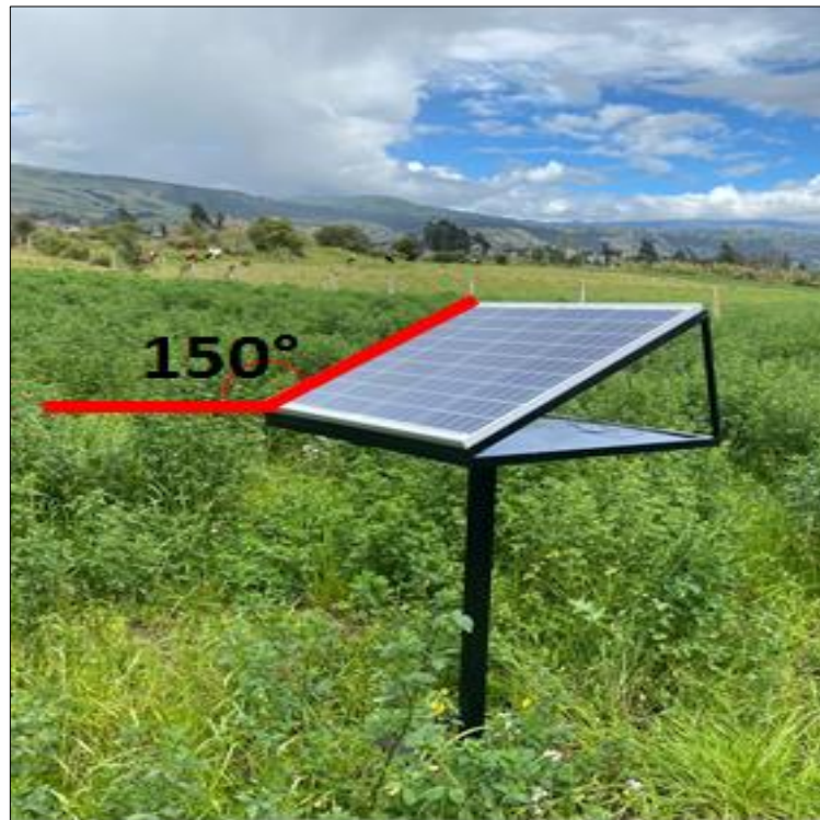
Figura 26-2: Estructura metálica para protección de panel fotovoltaico
