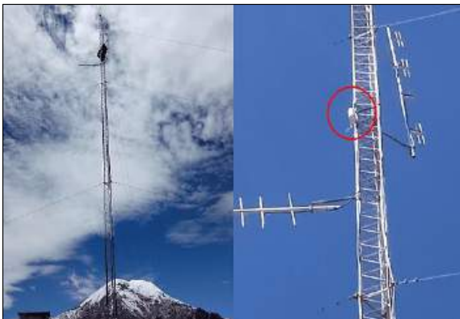
Figura 9-3: Nodo coordinador instalado
