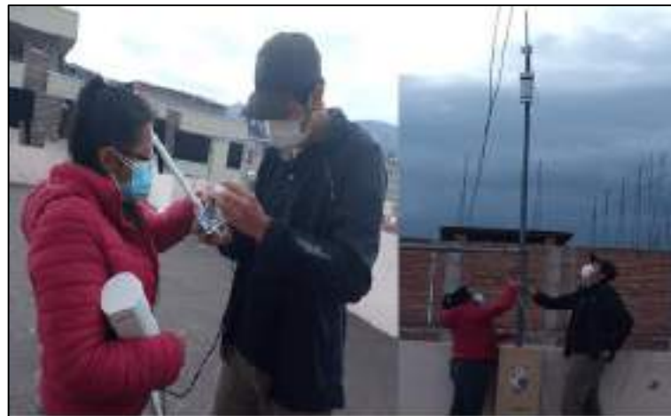
Figura 6-3: Instalación del nodo coordinador en zona urbana
